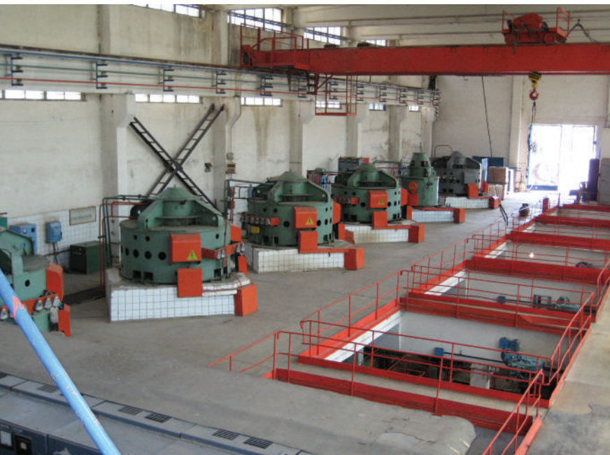
Машинный зал Главной канализационной насосной станции
