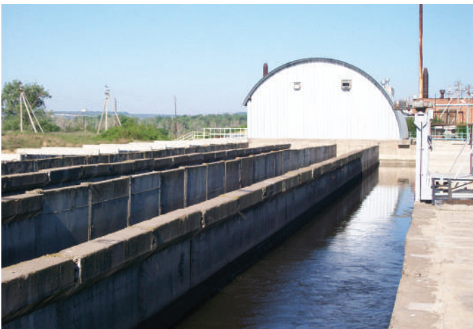
Станция ультрафиолетового обеззараживания
