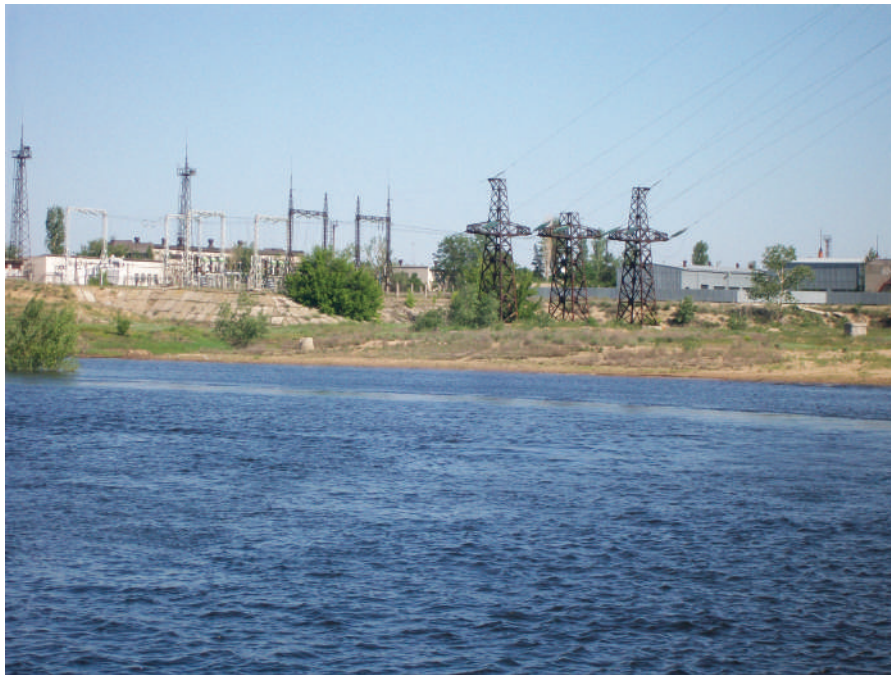
Подстанция «Островная». Анкерные опоры линий электропередач
