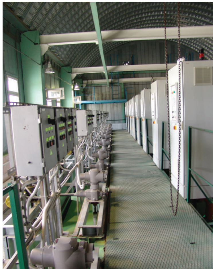
Станция ультрафиолетового обеззараживания
